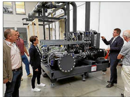
Geschäftsführer Matthias Knoll mit Bürgermeisterin Doris Schröter und Gemeinderatsvertretern vor einem Pumpenaggregat für eine zentrale Filteranlage.
