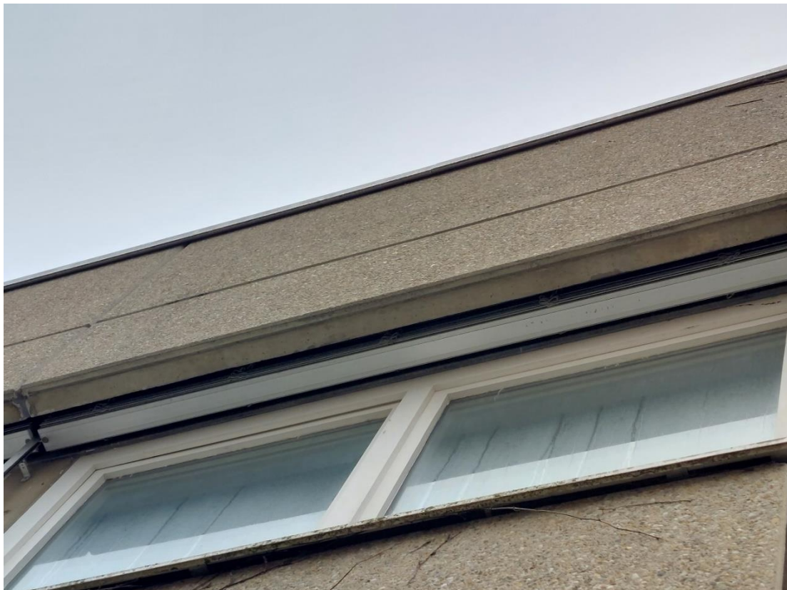
Abbildung 11: Rollladenkästen Flachdachhaus, evtl. Potenzial für Lebensstätte
