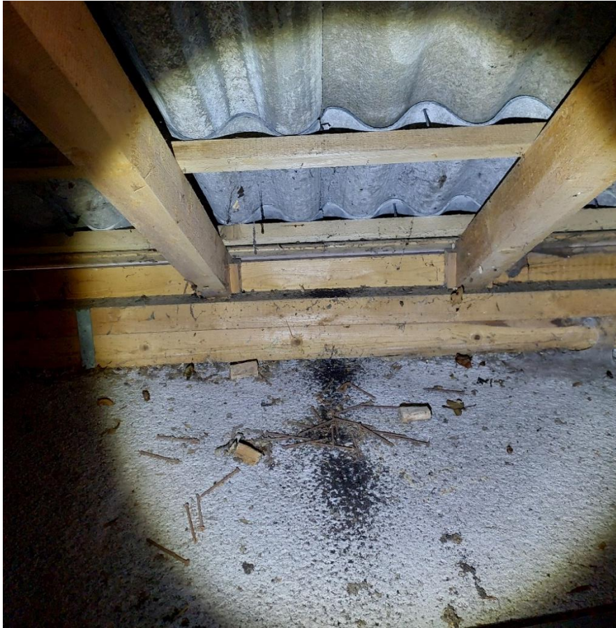
Abbildung 10: Garagen-Dachstuhl, Fledermauskot, Tagesquartier, evtl. kleine Wochenstube
